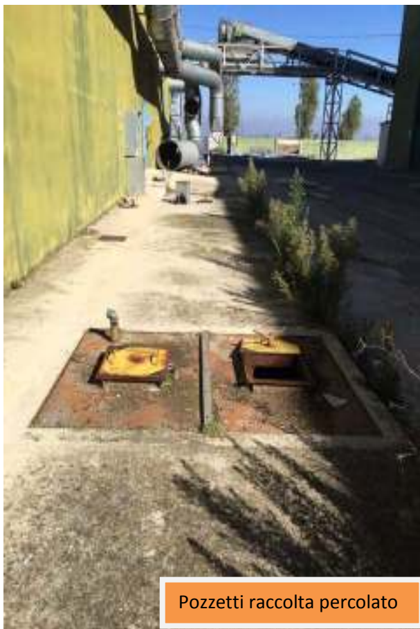
Pozzetti raccolta percolato
