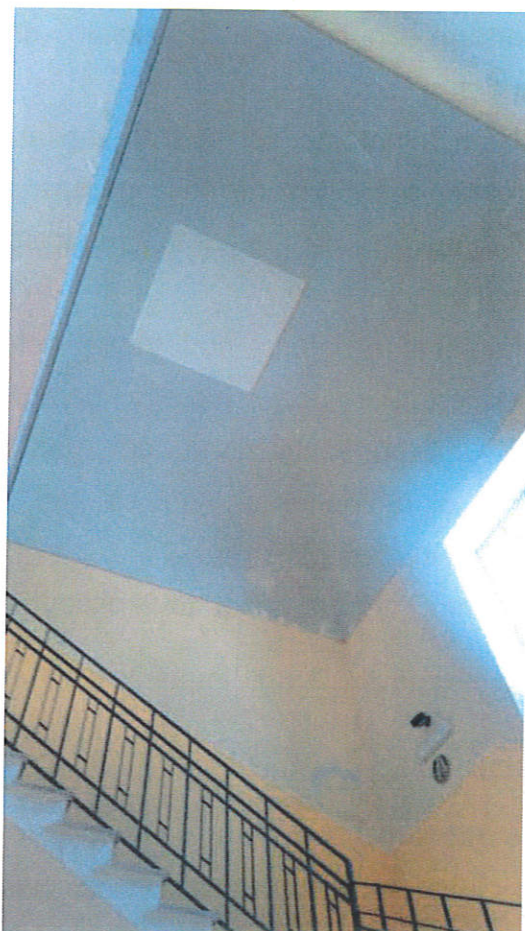
Figura 5 _Infiltrazioni vano scala
