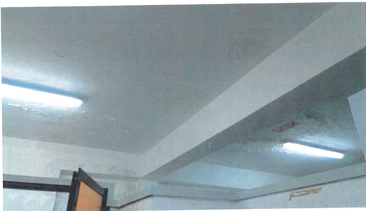
Figura 3 _Infiltrazioni solaio copertura spogliatoi
