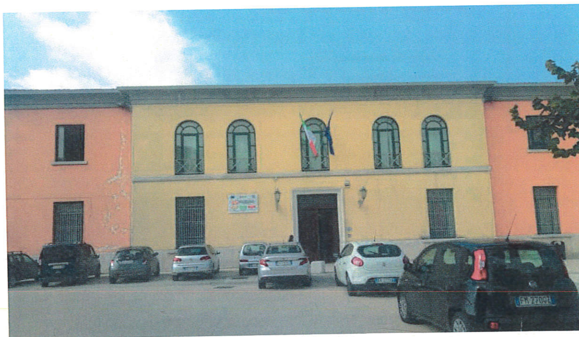
Figura 4 _Infiltrazioni su prospetto principale
