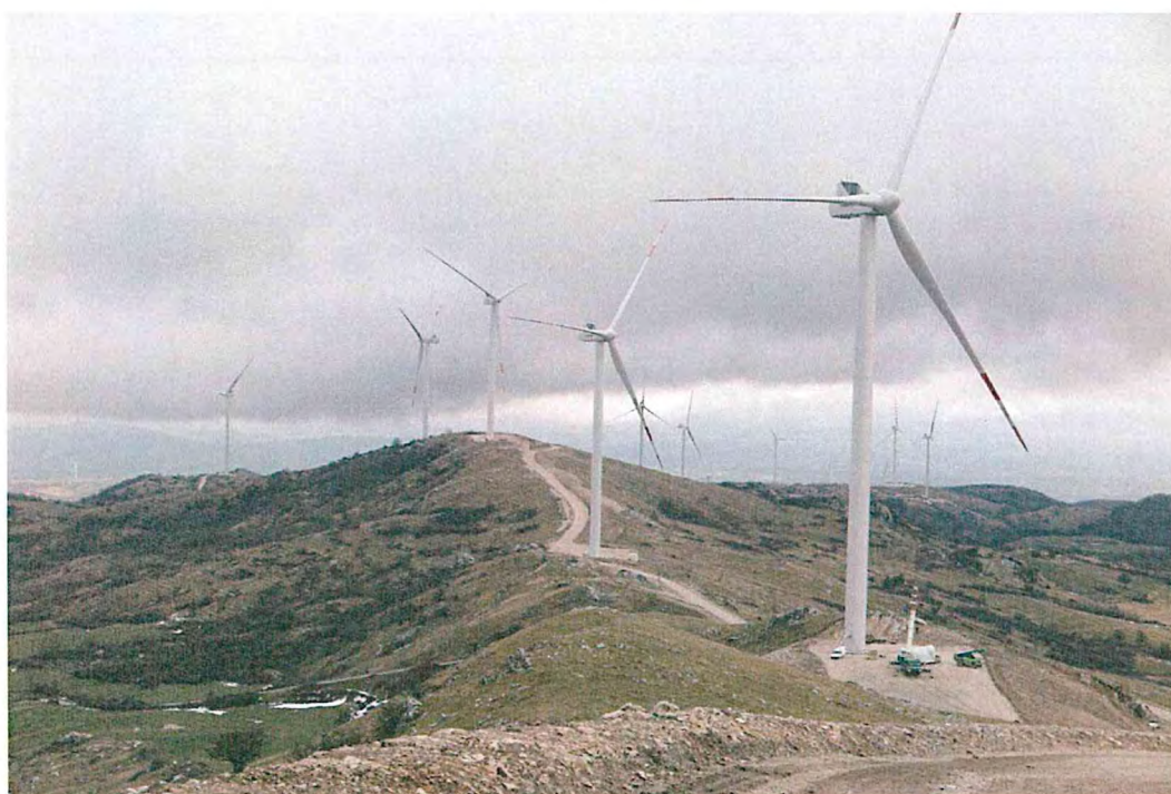
Foto 18 - Sbancamenti per piazzole e nuove strade nella zona sud orientale del parco e accumulo evidente di materiale ai bordi delle strade sull'habitat di Direttiva 6210 e, potenzialmente, 6210*
