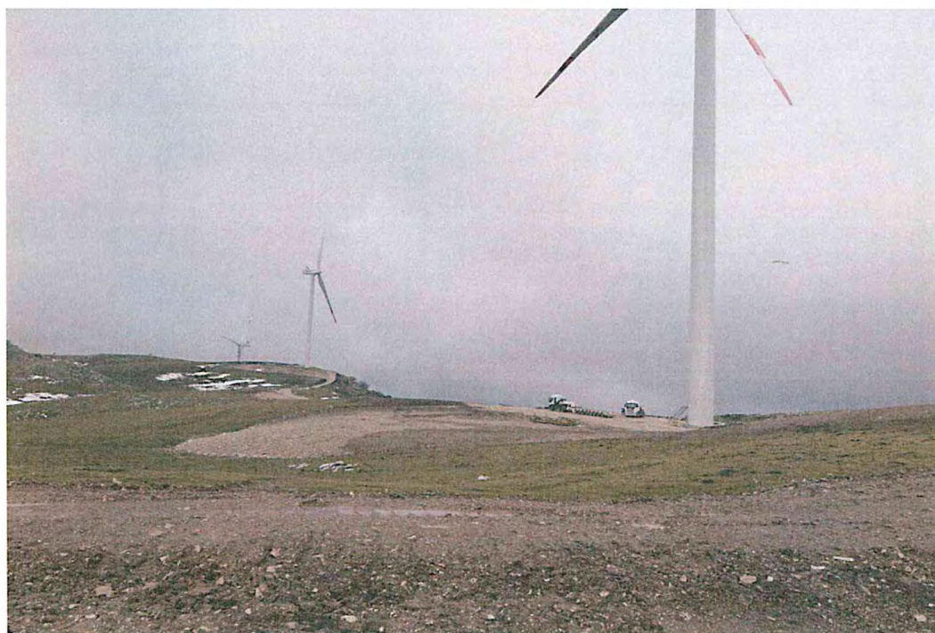
Foto 6 - Suolo sul quale esistevano praterie afferenti agli habitat di Direttiva 6210 e, potenzialmente, 6210*, scavato, rimaneggiato ed accumulato su altre praterie come materiale di risulta
