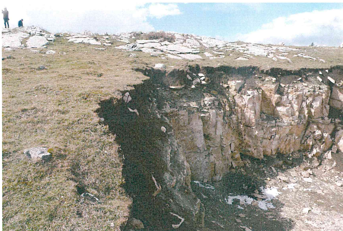
Foto 10 – La collinetta con i pavimenti calcarei (habitat di Direttiva 8240*) della foto 9 tagliata da uno sbancamento per realizzare un'area di manovra e/o stoccaggio
