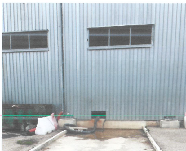
Foto n. 3 – VISTA PIAZZOLA E PRESA DI CARICO PERCOLATO
