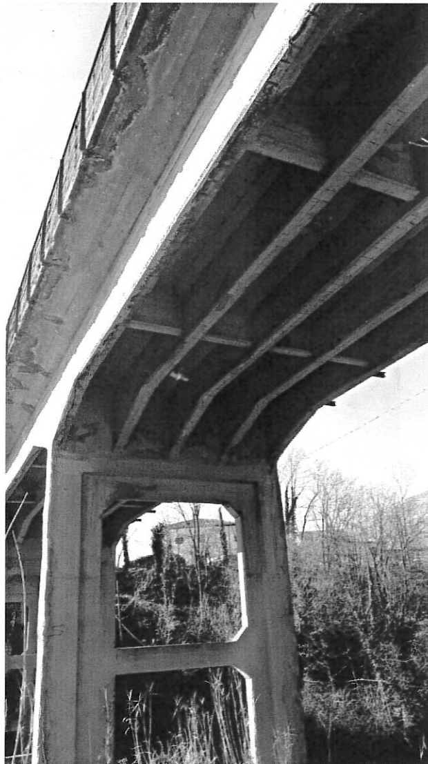
Dettaglio delle travi d'impalcato con fenomeni di degrado corticale
