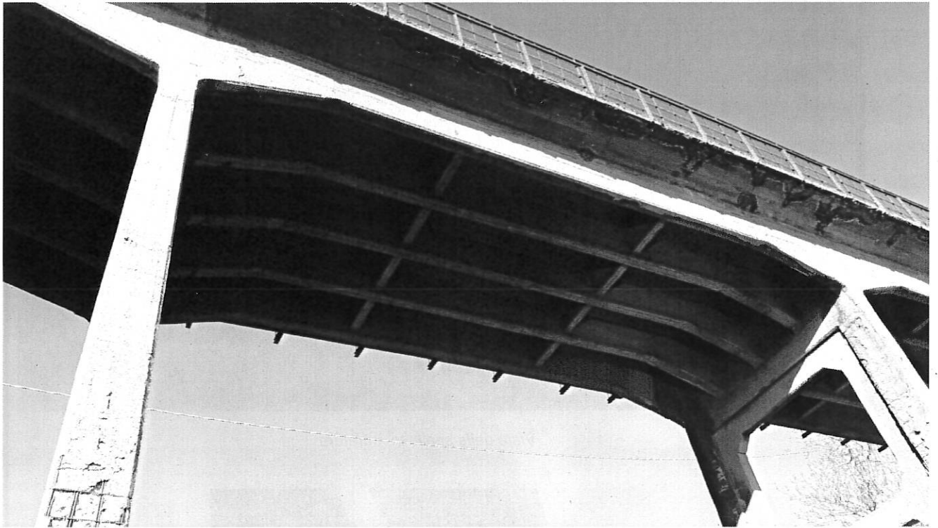
Dettaglio delle travi d'impalcato e delle pile con fenomeni di degrado corticale
