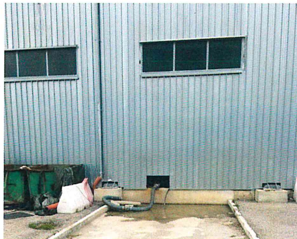
Foto n. 3 – VISTA PIAZZOLA E PRESA DI CARICO PERCOLATO
