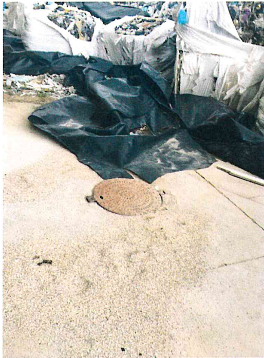
Foto n. 1 - Pozzetto raccolta percolato
