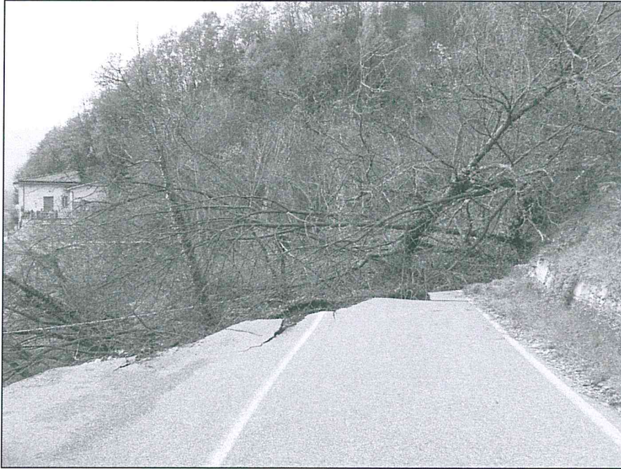
Figura 3.5 Immagini del dissesto sulla SP1 – vista direzione AV
