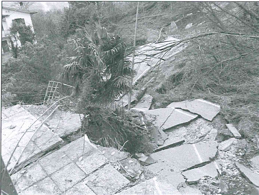
Figura 3.6 Immagini del dissesto sulla SP1 – relitto stradale
