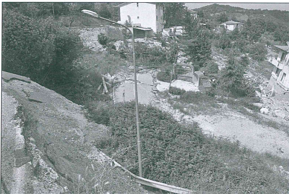
Figura 3.3 Immagini del dissesto sulla SP1 – vista in direzione BN
