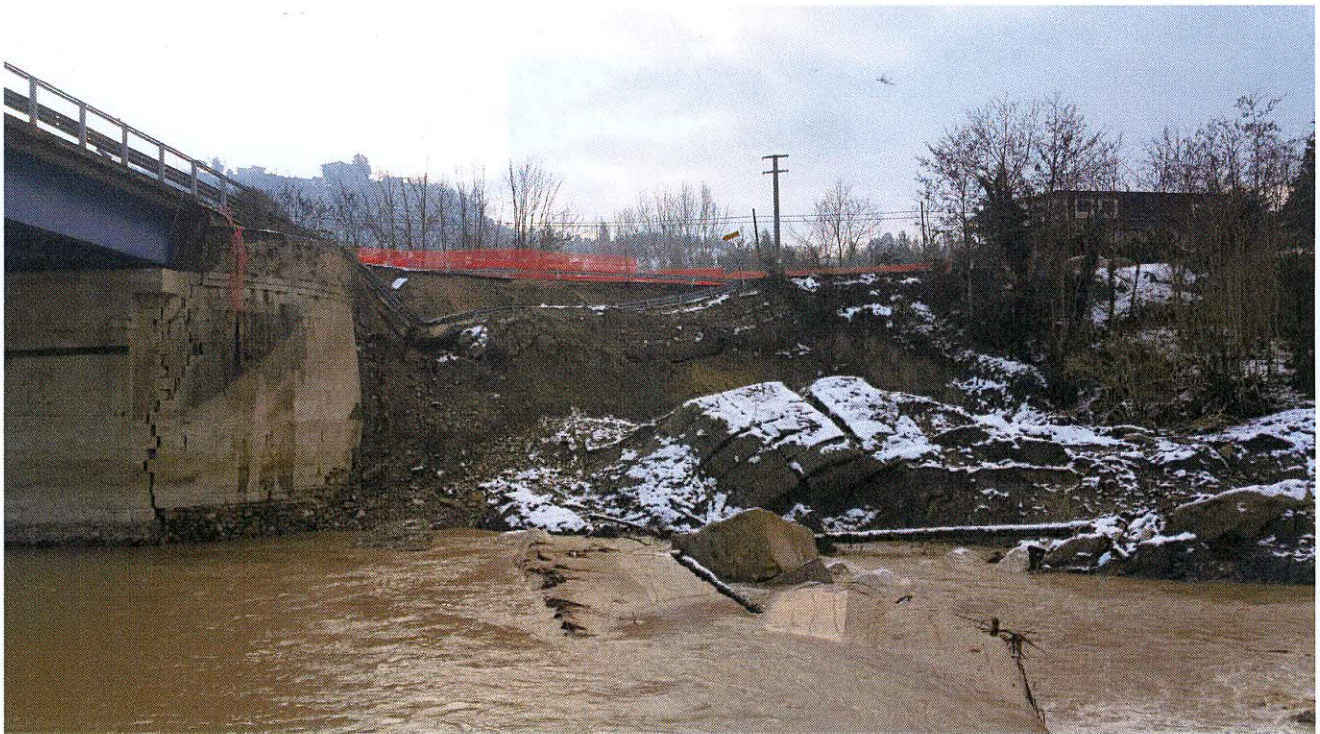
Fronte di frana
