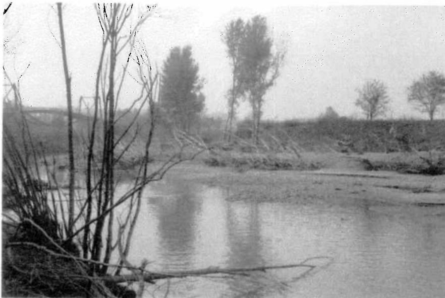
Lavori di somma urgenza sul fiume Fortore - Intervento in prossimità dei due ponti della RFI
