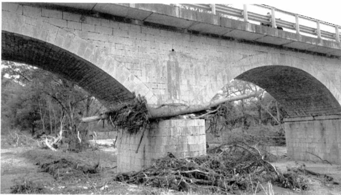
Resti di tronchi ancora non rimossi in adiacenza al ponte Calise
