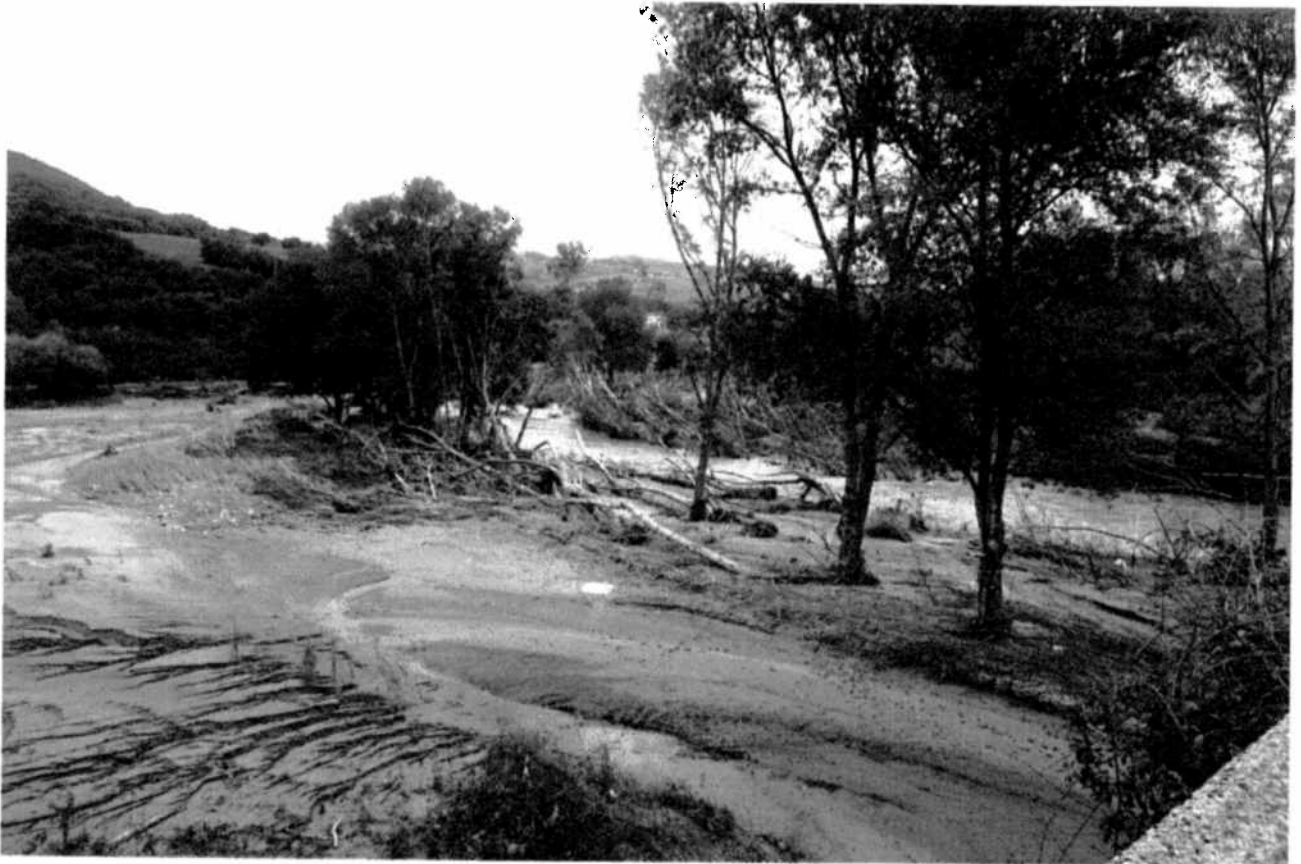
Particolare a valle del fiume dalla quale si evidenzia, in basso a sx, l'interramento delle gabbionate
